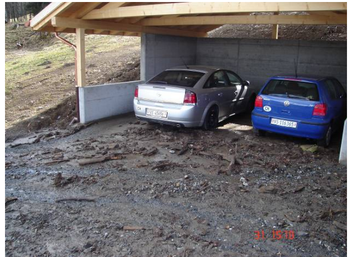
Photo 2 : Débordement solide sur la route des Giettes
