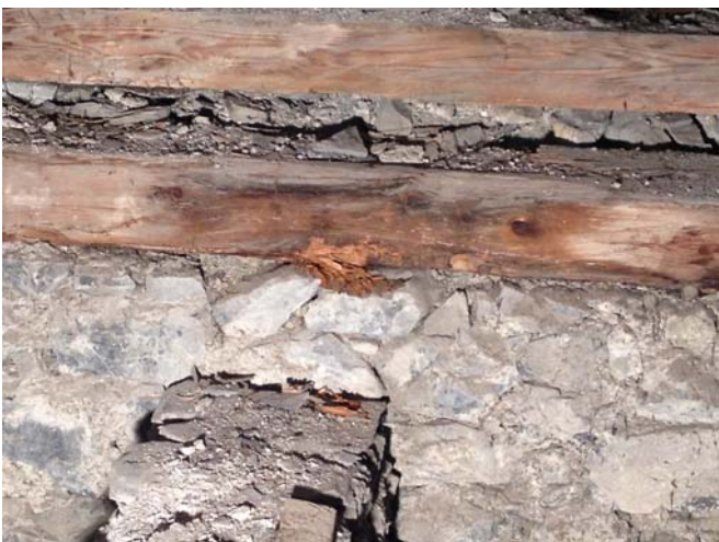
Sablère en mauvais état
