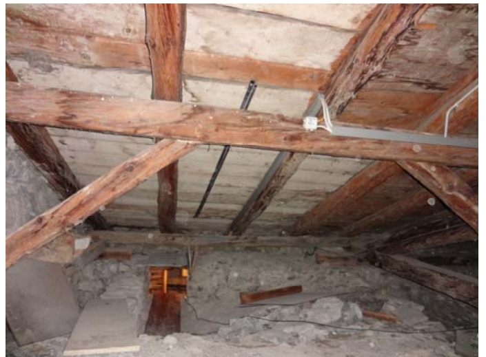
Charpente attaquée par la mэрule, à remplacer
